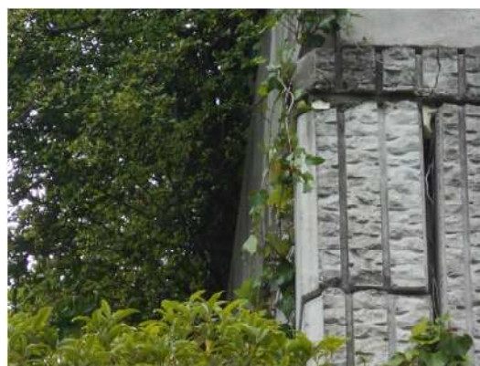
天端パネルの前傾及びクラック
