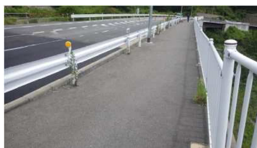
転落防止柵の後傾，歩道路面の変状
