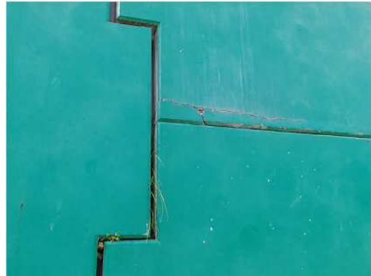
クラック部詳細状況
