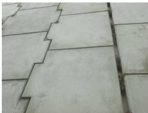
壁面の角欠け
